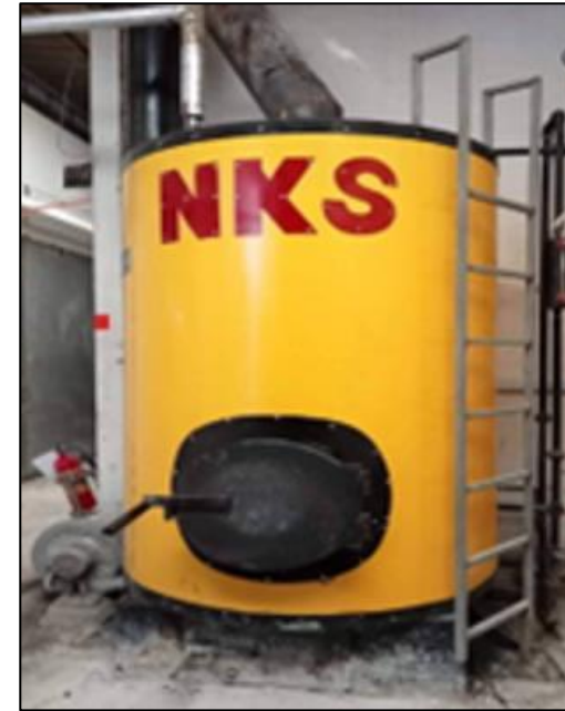
薪ボイラ(CWKH社仕様)
