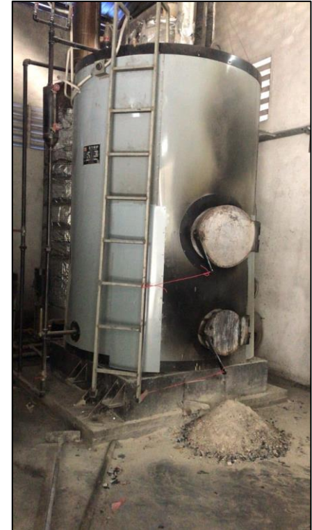
薪ボイラ(SLSG社仕様)
