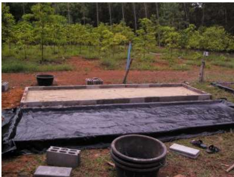
写真 11 プール底面に砂を敷いた状態(奥)とその後防水シートを敷いた状態(手前)
